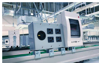
200V電源コンセント口
